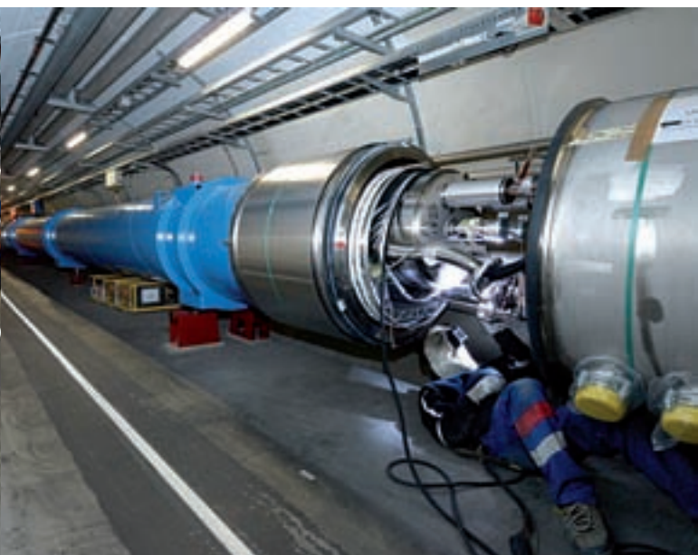
Detalle de las conexiones entre dos imanes del LHC. Un fallo en una conexión como ésta provocó la fuga de helio del 19 de septiembre de 2008 que ha obligado a realizar reparaciones durante más de un año antes de volver a ponerlo en marcha.
